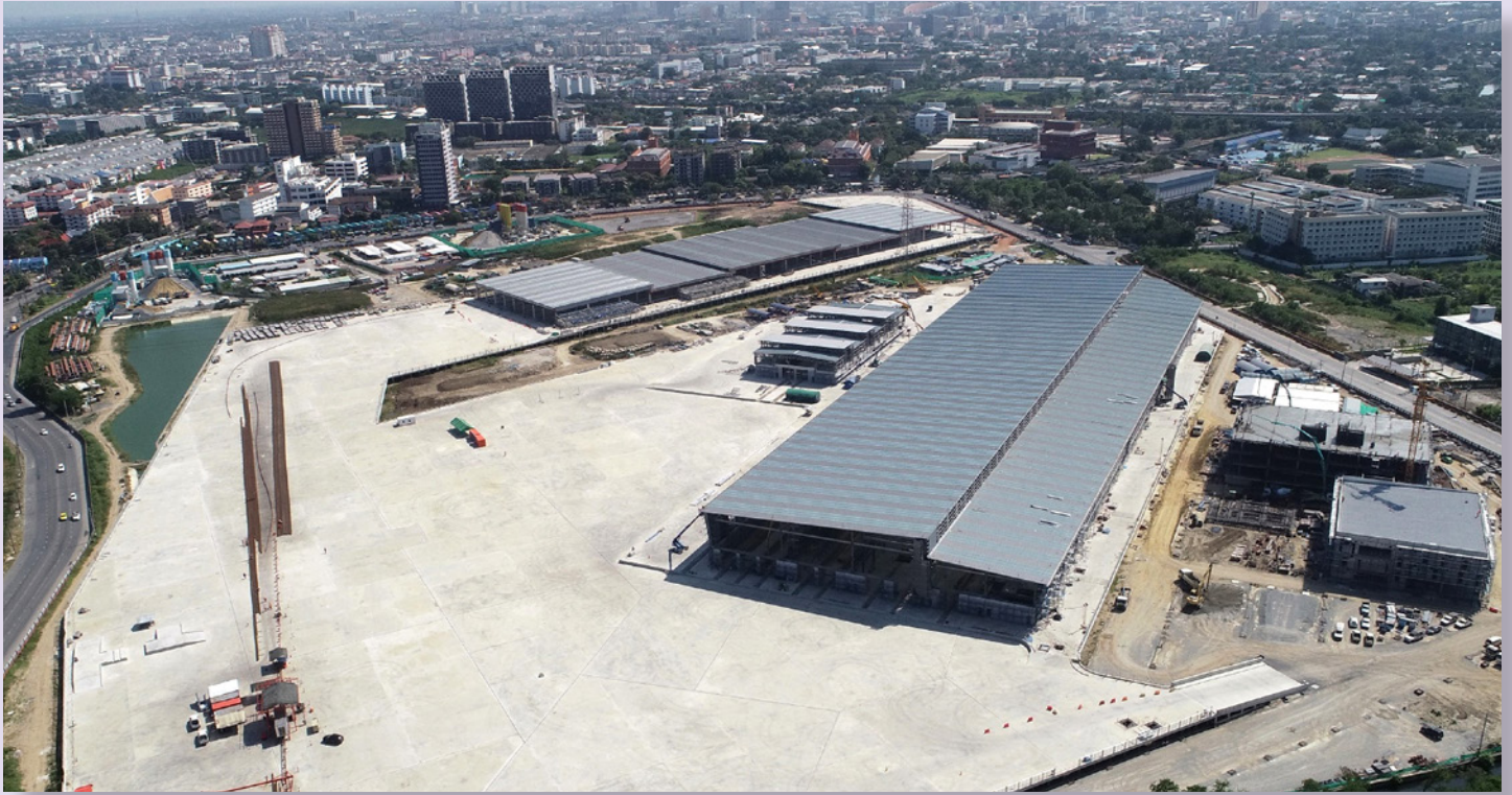
กว่าจะเป็นศูนย์ซ่อมบำรุงรถไฟฟ้าสายสีส้มปี 2562
