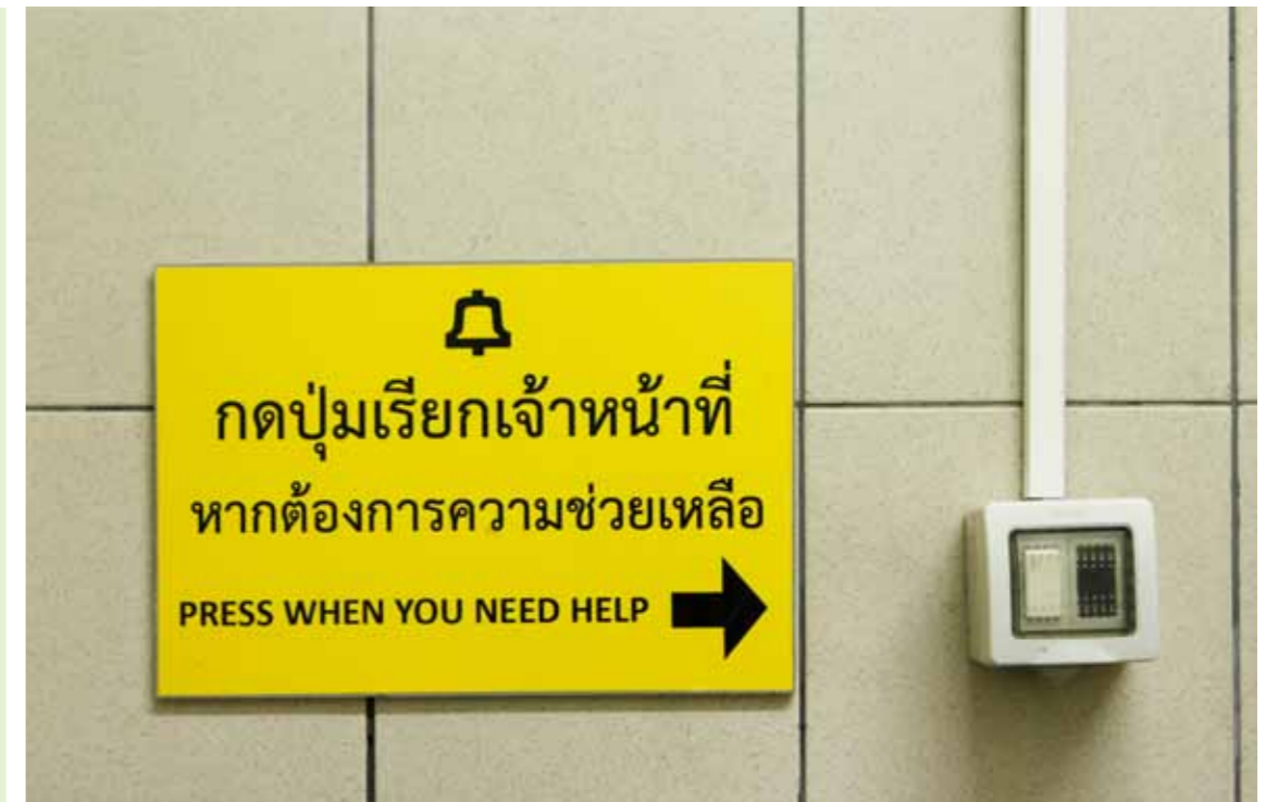
❖ 6. สวิตช์แจ้งขอความช่วยเหลือในห้องน้ำผู้พิการชั้น G อาคารจอดรถ 9 ชั้น สถานีลาดพร้าว
